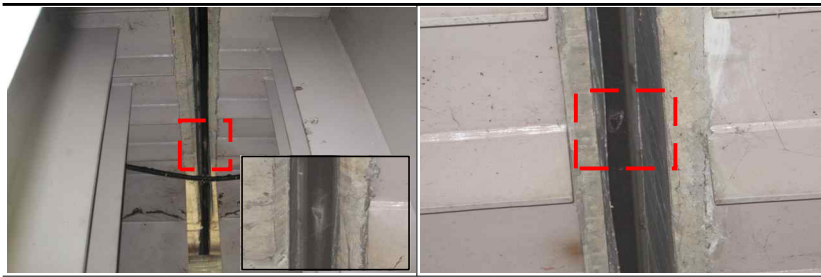
① 신축이음 P3 하부(양방향) - 파손 진전여부확인
